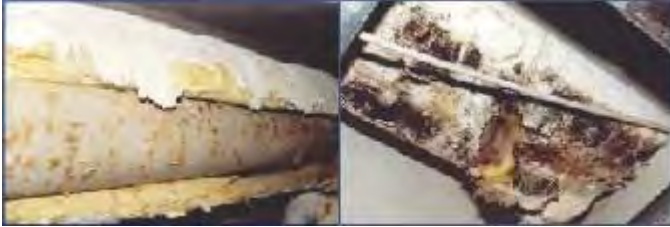
Yoğuşma sonucu kanalın yalıtımının deformasyonu
