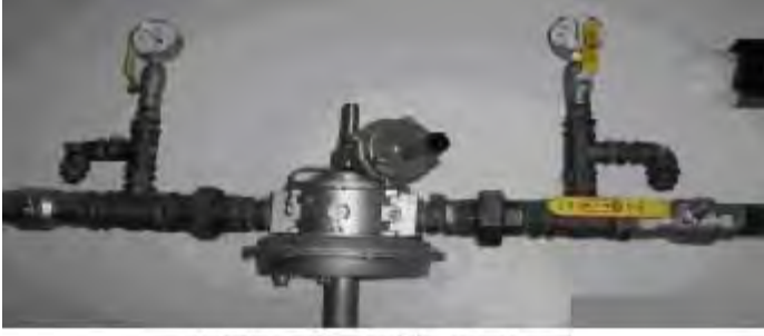
Regülatörün gaz tesisatındaki yeri
