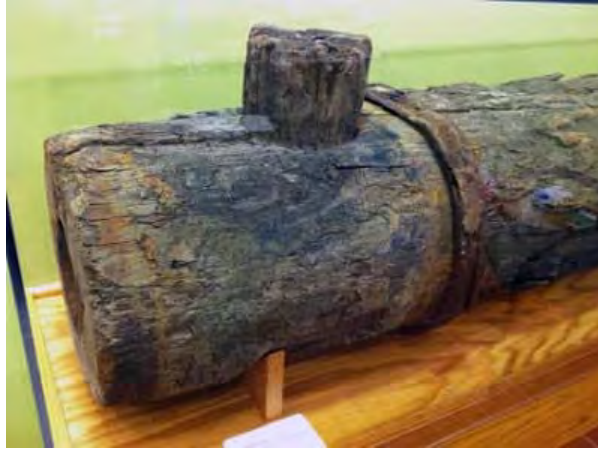
Eski Hidrant Besleme Boruları
